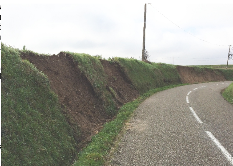
Figure n°8 : glissement de talus
